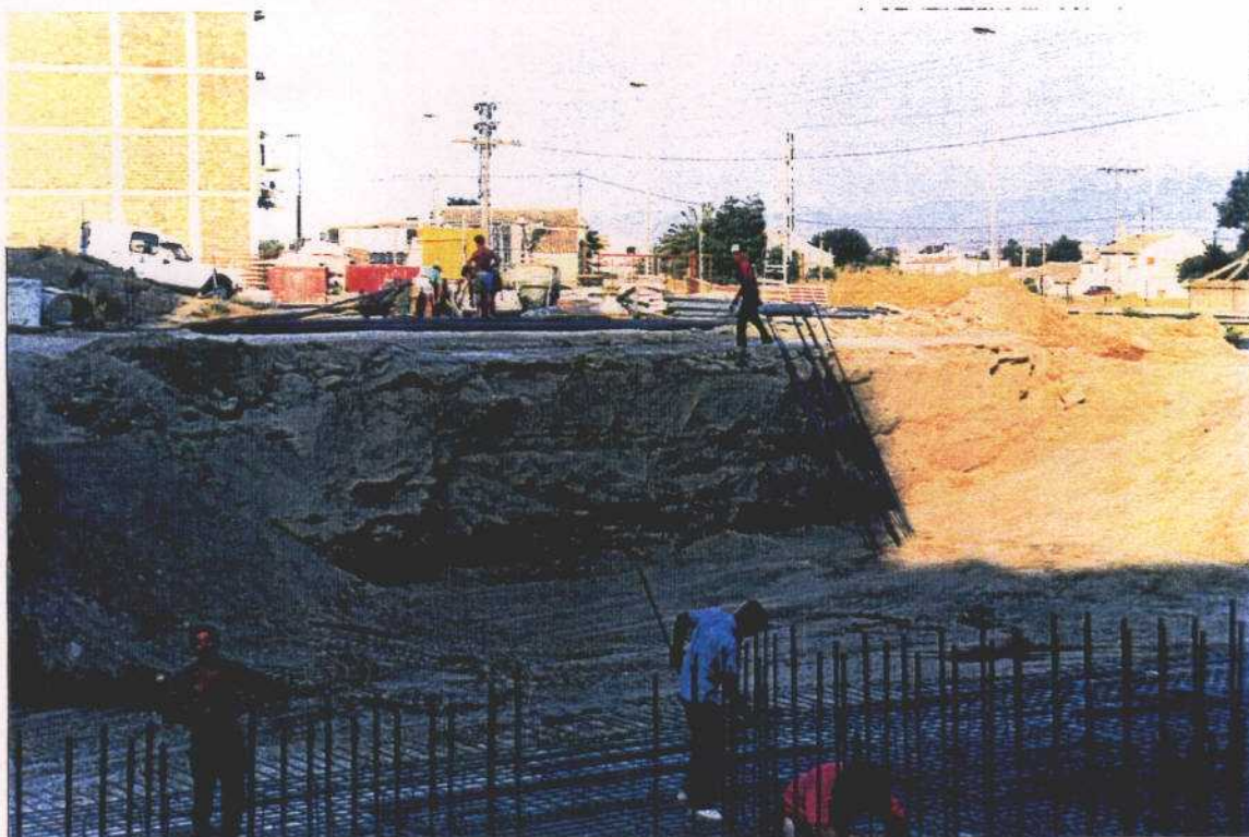
FOTOGRAFIA N°1 Detalle de los materiales del subsuelo; materiales limo-arcillosos con contenidos variables en arcillas. Material flojo que precisa de cimentaciones mediante pilotes (profundas) o de grandes losas de reparto de cargas.
